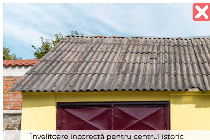
Învelitoare și lucarne neadaptate la fațadă
