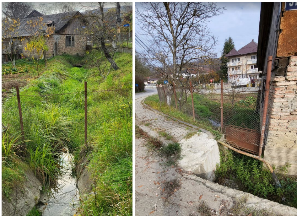
Imagine 5.34 Canal scurgere între str. Lempes și str. Cocorului, pe partea dreaptă a str. Valea Budacului
