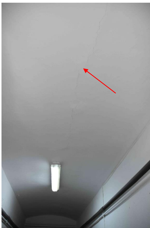
Foto nr. 42 – Fisură la cheie a planșeului tip boltă - coridor demisol
