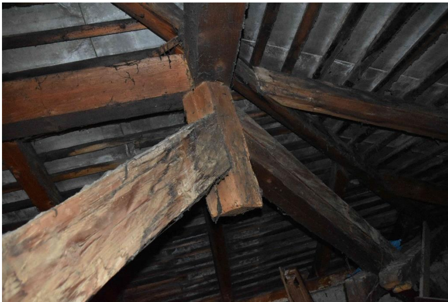
Foto nr. 55 – Degradări și deficiențe locale la nivelul îmbinărilor dintre elementele de șarpantă
