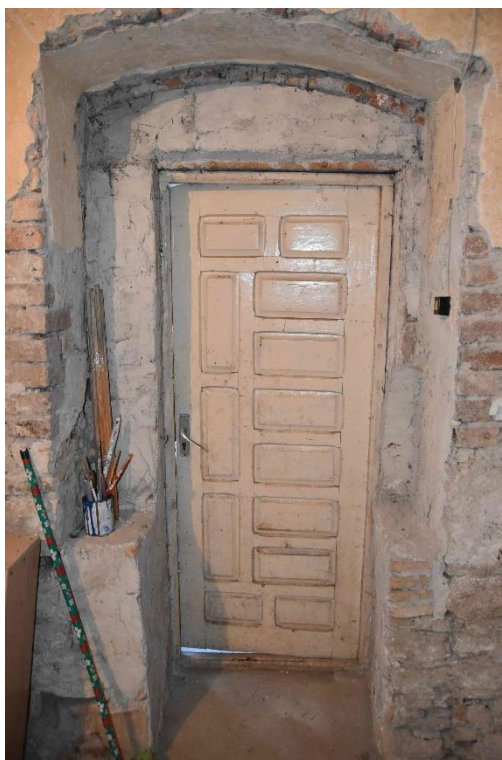
Foto nr. 32 – Gol de ușă realizat prin spargerea unui parapet de geam, realizat necorespunzător - magazie demisol zona interax 1-2/B-E
