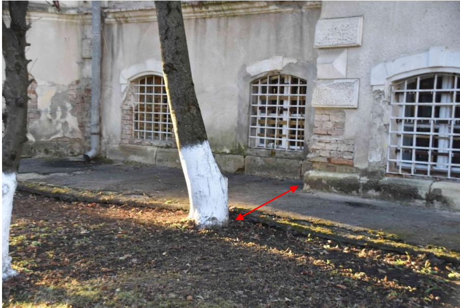
Foto nr. 13 – Degradări ale trotuarului perimetral, prezența arborilor în apropierea construcției \approx 2.00 m (fațadă sud-estică)
