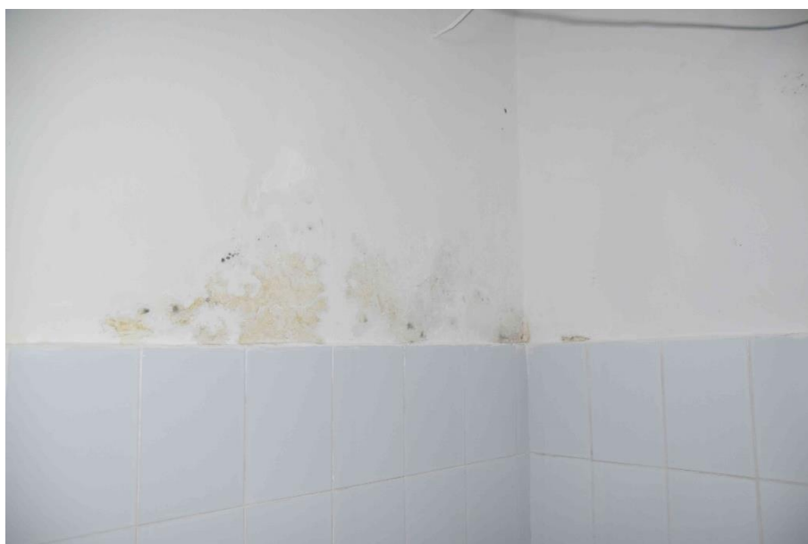
Foto nr. 40 – Degradări cauzate de infiltrații de apă, igrasie - spălătorie demisol
