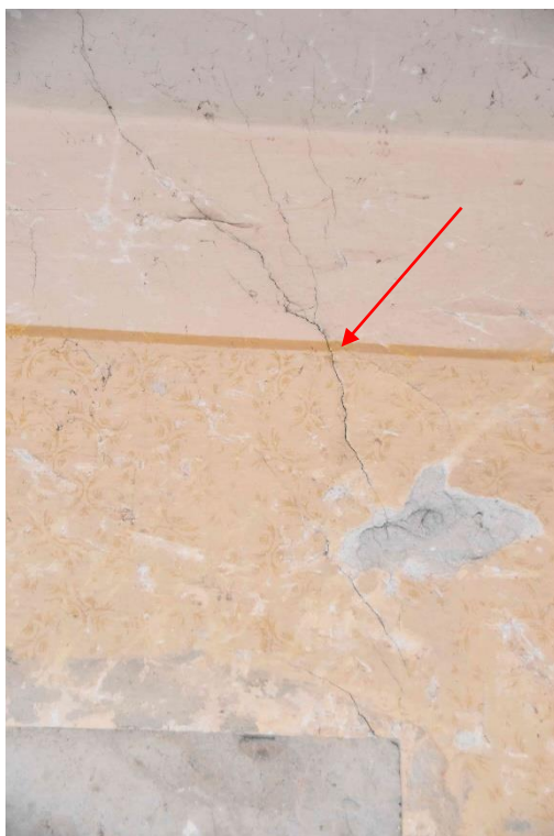
Foto nr. 33 – Fisură perete - magazie demisol zona interax 1-2/B-E
