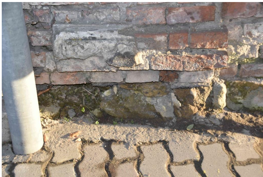
Foto nr. 15 – Degradări ale zidăriei din piatră în zona de soclu (fațadă nord-vestică)
