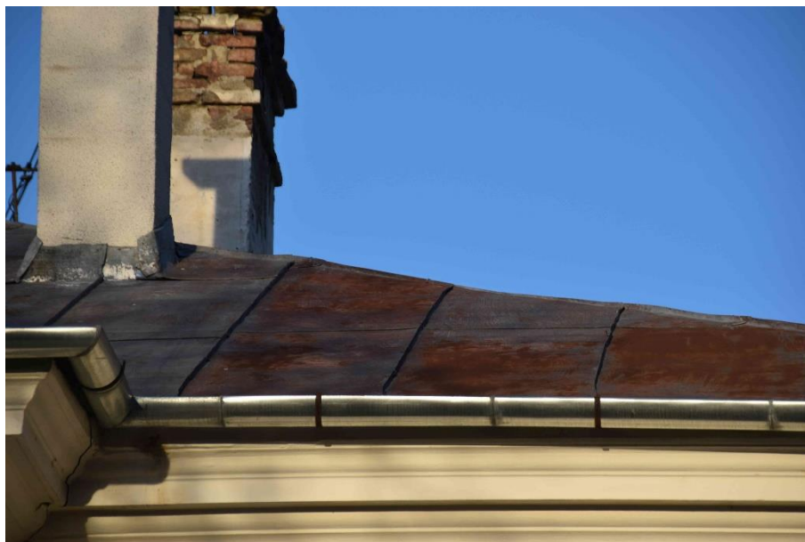
Foto nr. 27 – Degradări, corodări ale învelitorii
