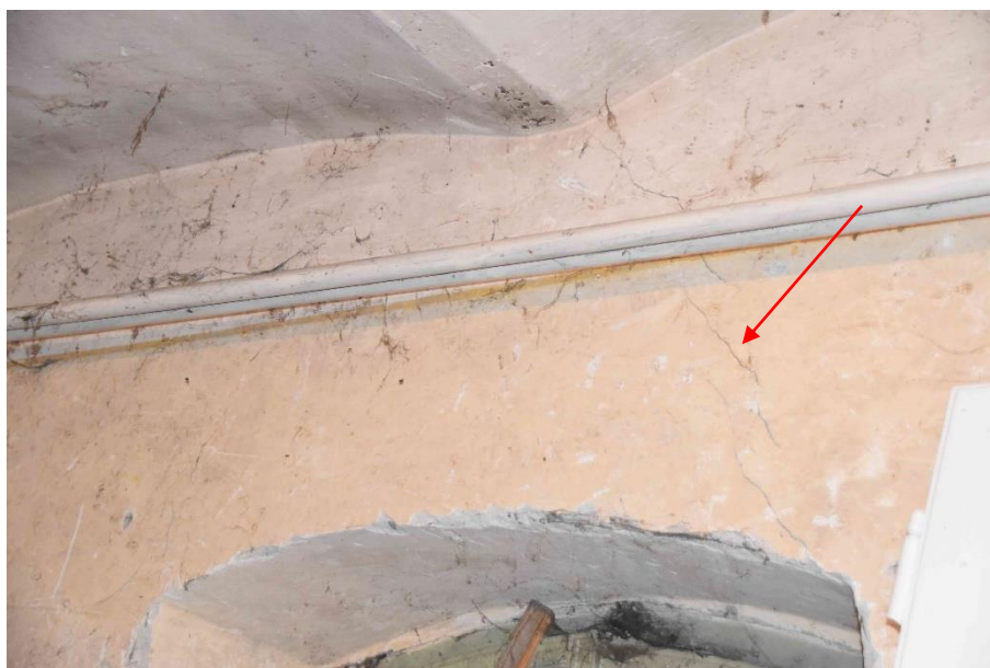
Foto nr. 34 – Fisură perete - magazie demisol zona interax 1-2/B-E
