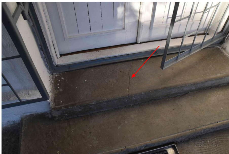
Foto nr. 11 – Fisuri în scări - zonă acces fațadă sud-estică
