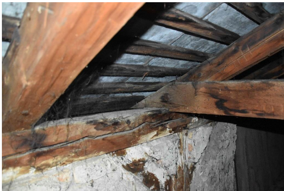
Foto nr. 57 – Degradări la nivelul elementelor de șarpantă cauzate de infiltrații de apă
