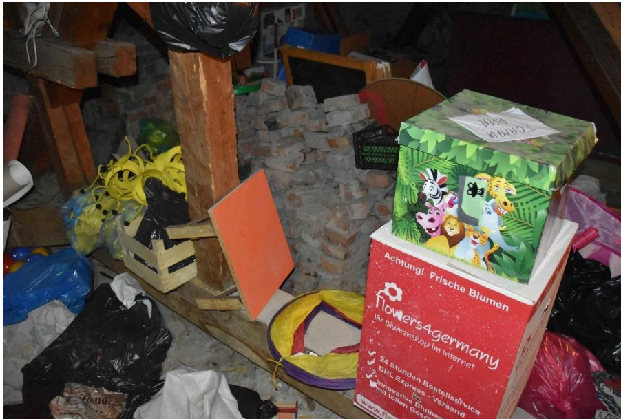
Foto nr. 53 – Depozitarea necorespunzătoare a diferitelor obiecte didactice și materiale de construcții pe planșeu de pod
