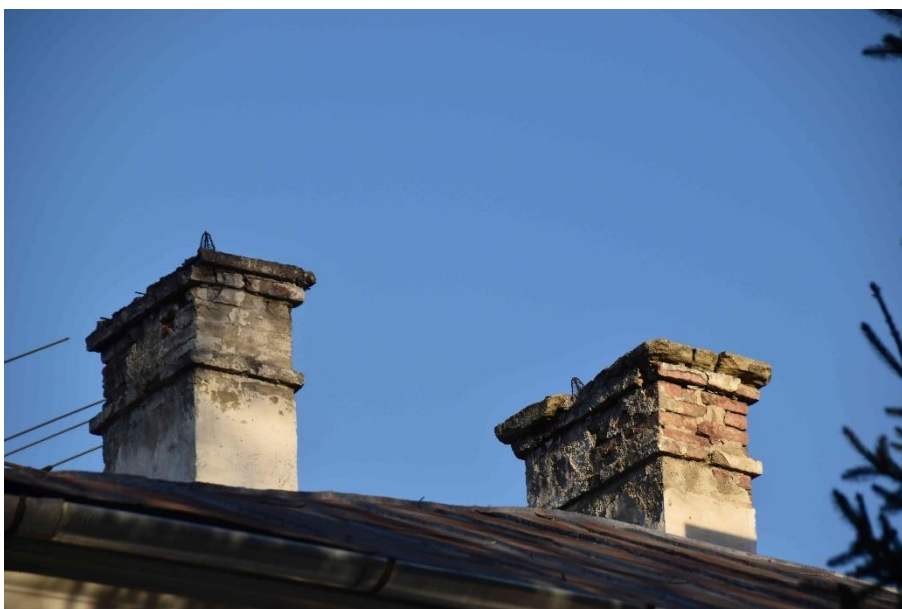
Foto nr. 26 – Degradări ale coșurilor de fum
