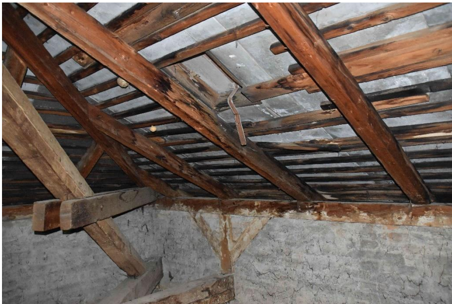
Foto nr. 59 – Degradări și deficiențe la nivelul șipcilor
