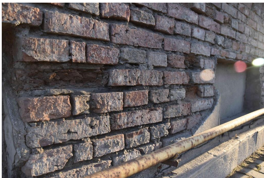
Foto nr. 16 – Degradări ale zidăriei de cărămidă plină (fațadă nord-vestică)
