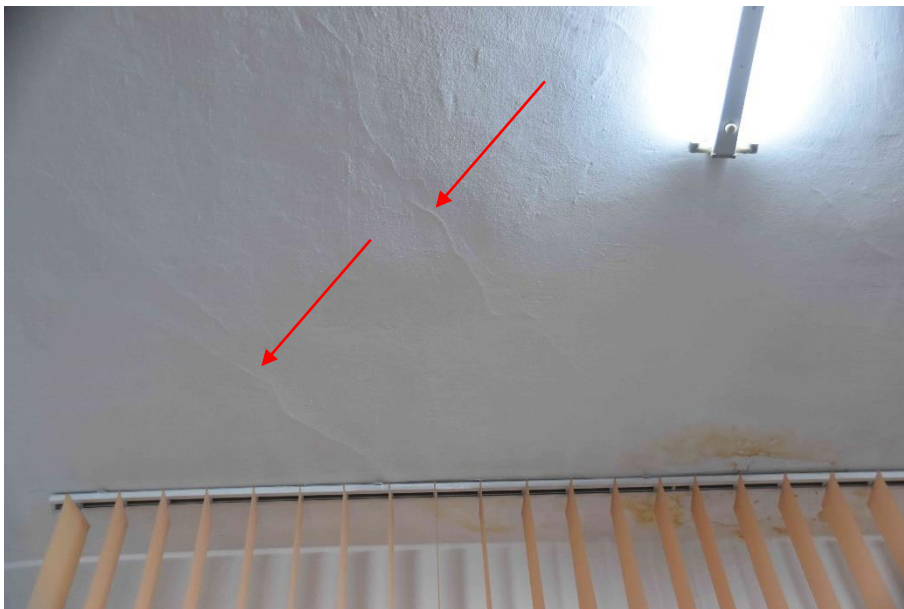
Foto nr. 48 – Fisuri la nivelul tavanului - birou director parter
