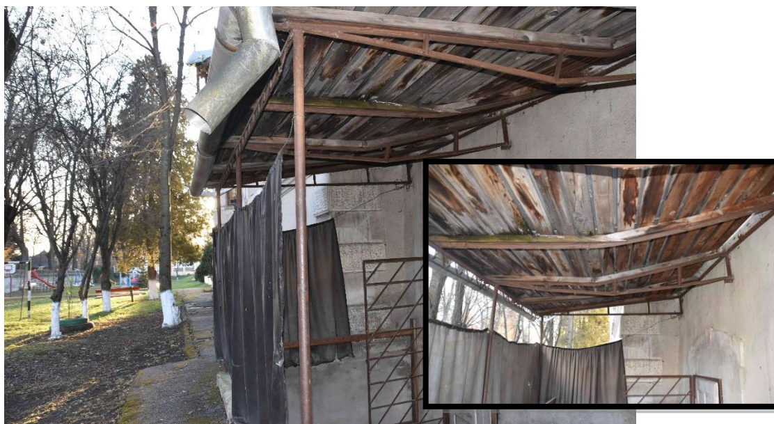
Foto nr. 8 – Copertină neconformă, cu cedări de elemente - zonă acces demisol fațadă sud-estică
