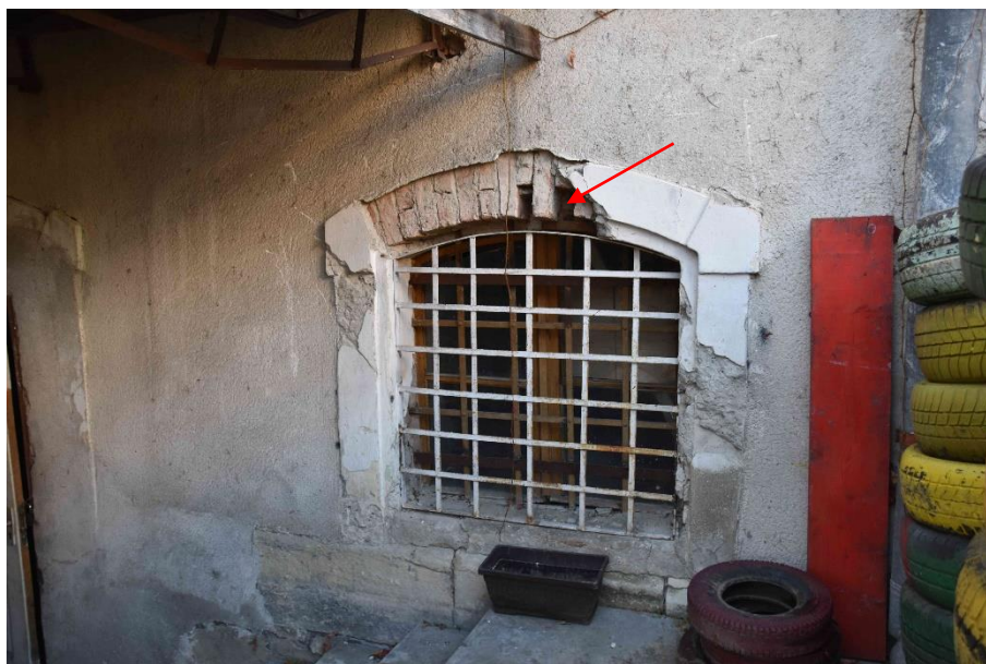
Foto nr. 17 – Degradări ale buiandrugului, dislocuiri de elemente de zidărie (fațadă sud-estică)
