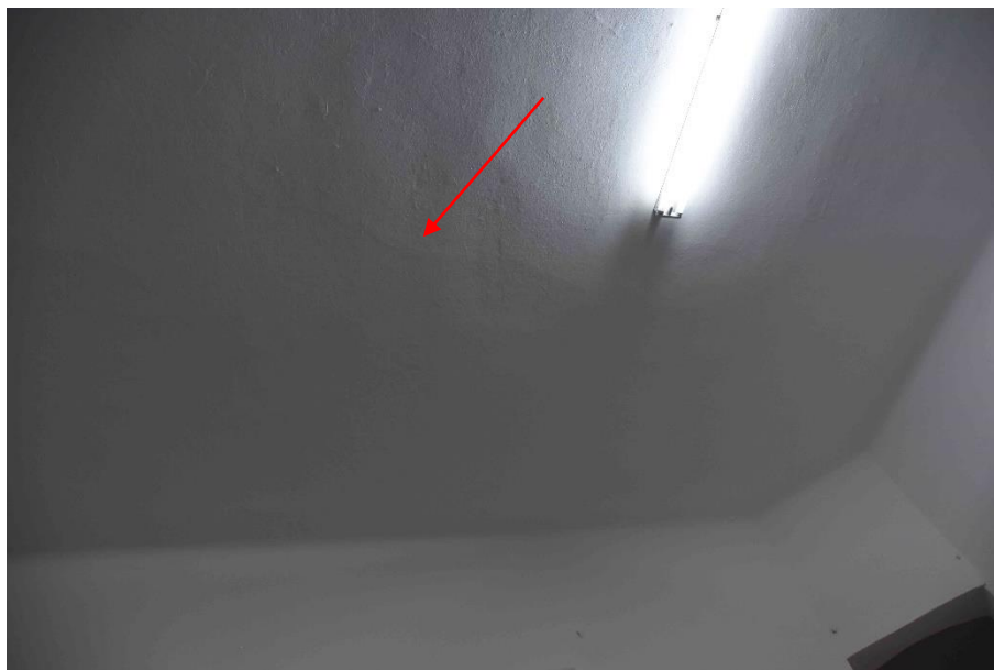
Foto nr. 49 – Fisuri la nivelul tavanului – sală grupa 1 parter
