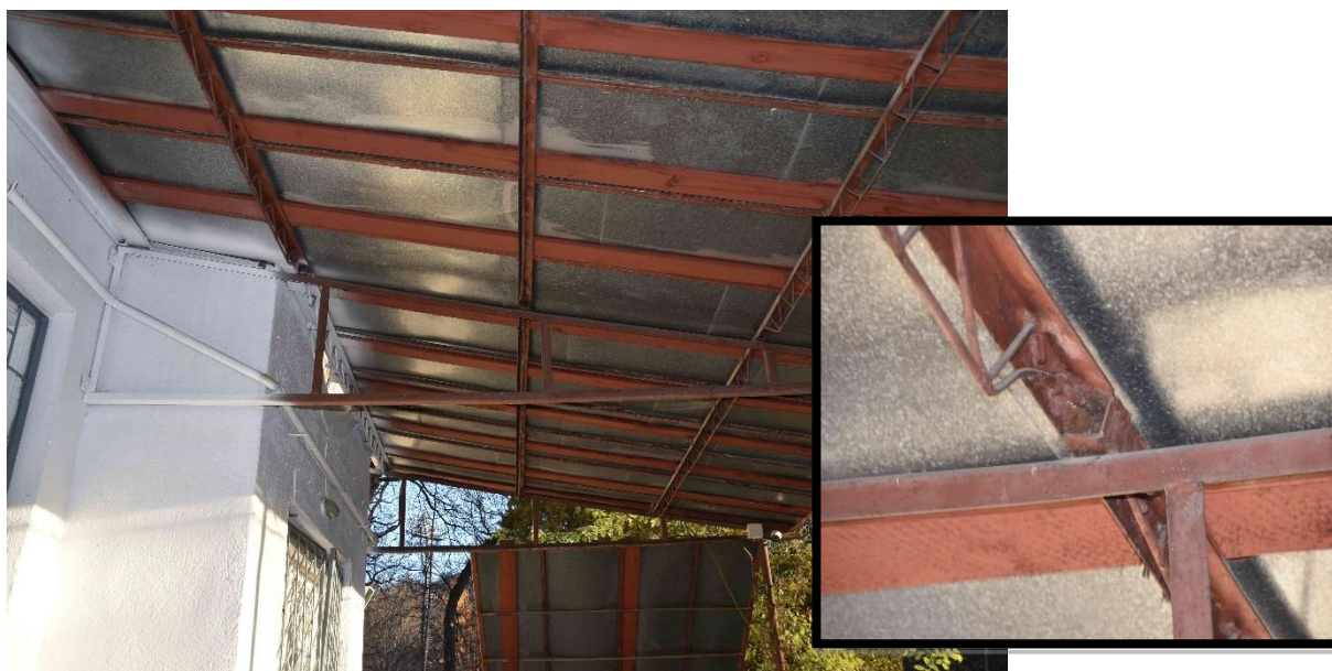
Foto nr. 12 – Soluții improvizate copertine metalice – zonă acces fațadă sud-vestică
