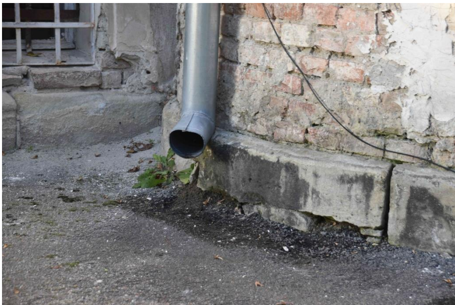
Foto nr. 14 – Deficiențe ale sistemului de colectare și evacuare a apelor pluviale, descărcarea apelor în imediata apropiere a construcției (fațadă sud-estică)
