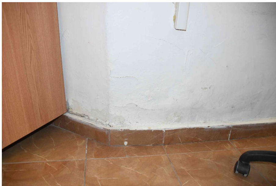
Foto nr. 39 – Degradări cauzate de infiltrații de apă prin capilaritate, igrasie - birou demisol
