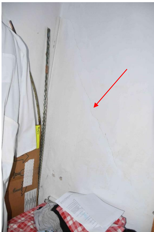
Foto nr. 41 – Fisură perete - cameră CT demisol
