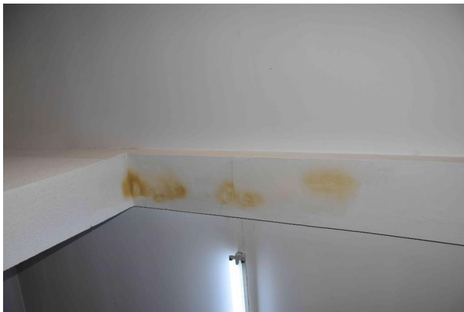
Foto nr. 45 – Degradări cauzate de infiltrații de apă de la nivelul acoperișului - sală parter
