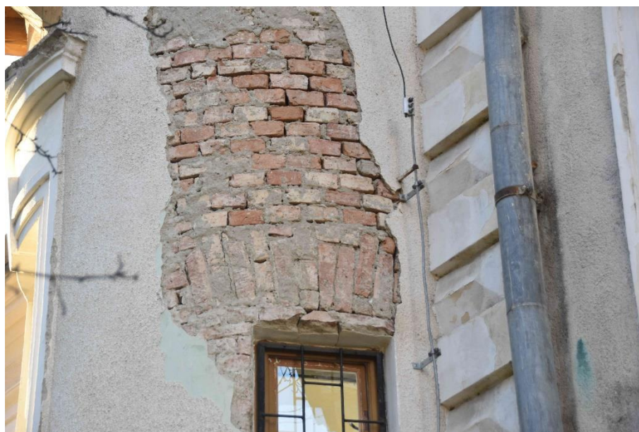
Foto nr. 22 – Degradări ale buiandrugului din zidărie de cărămidă plină (fațadă sud-estică)
