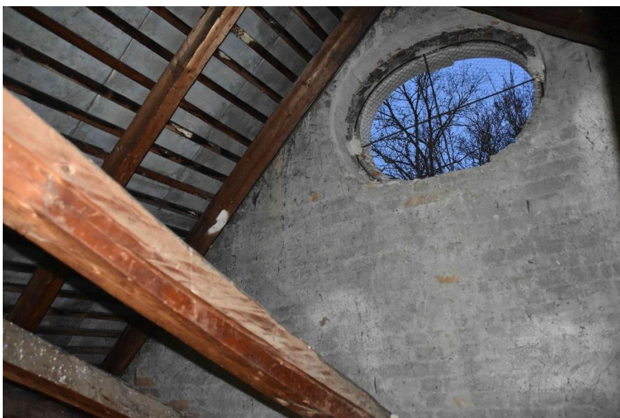
Foto nr. 60 – Timpan fațadă sud-ectică realizat din zidărie de cărămidă plină, fără elemente de conținere – sensibil la pierderea stabilității
