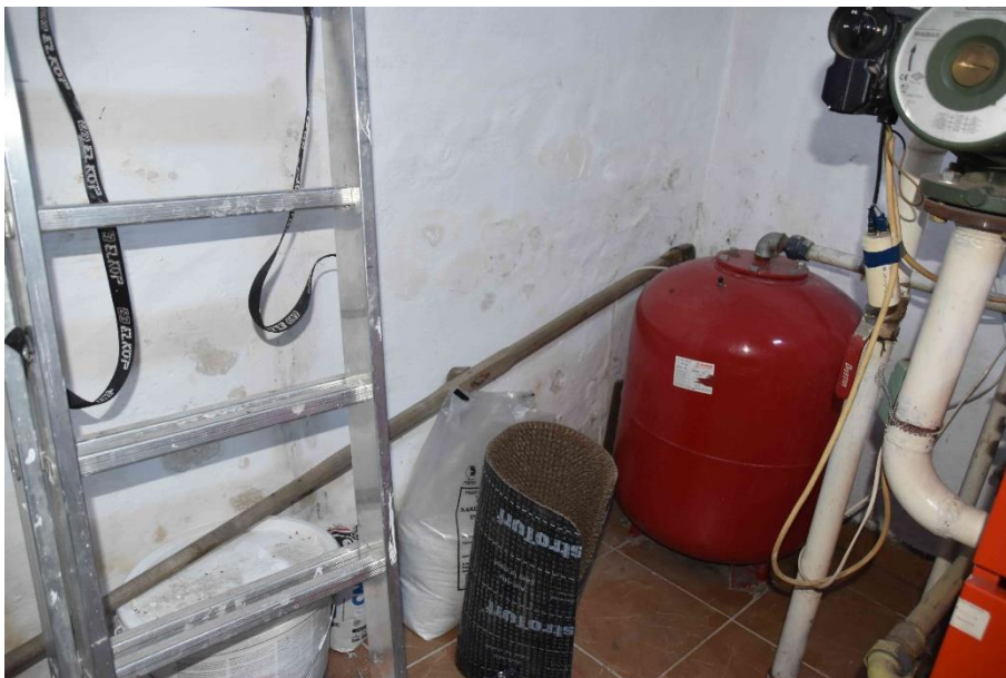
Foto nr. 38 – Degradări cauzate de infiltrații de apă prin capilaritate, igrasie - cameră CT demisol
