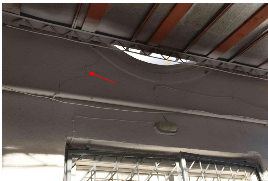
Foto nr. 20 – Fisură în zona golului de geam (fațadă sud-vestică)
