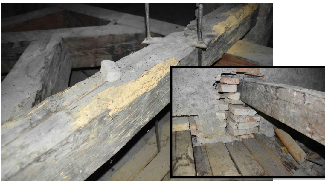
Foto nr. 52 – Degradări cauzate de atac de cari, rezemare necorespunzătoare – grindă meșter din cadrul sistemului de consolidare a planșeului de pod
