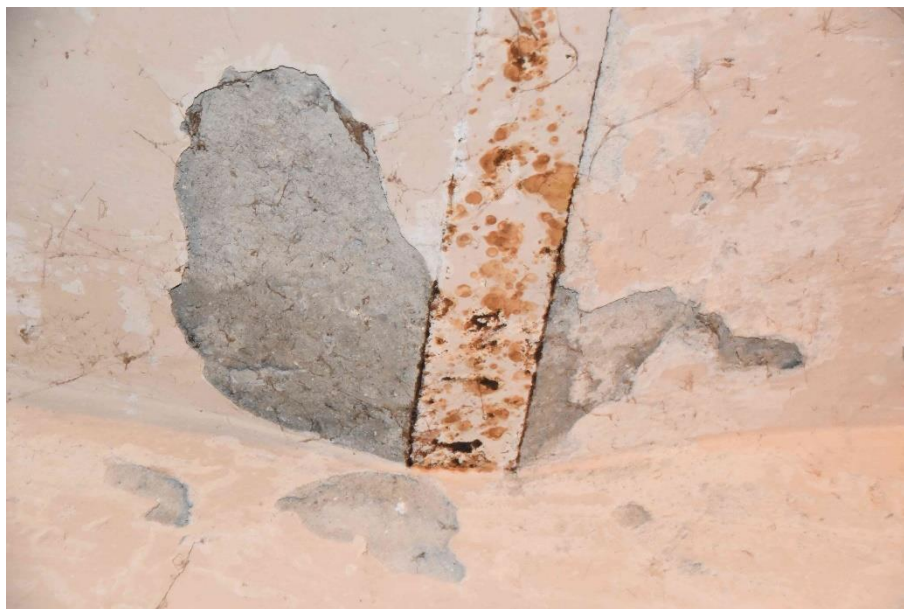
Foto nr. 35 – Corodare grinzi metalice de planșeu - magazie demisol zona interax 1-2/D-F
