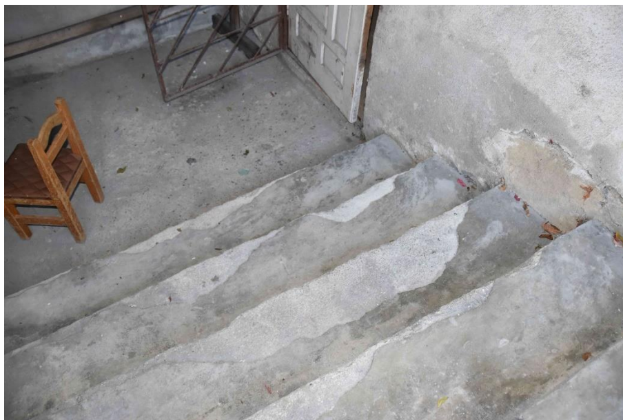
Foto nr. 9 – Degradări ale scărilor - zonă acces demisol fațadă sud-estică
