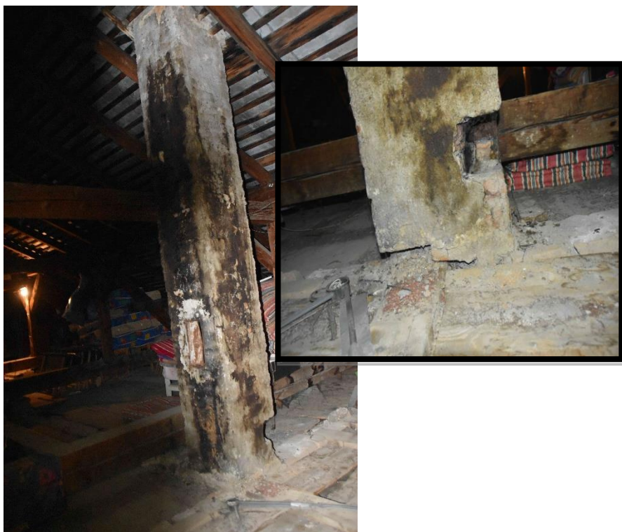
Foto nr. 61 – Degradări ale coșurilor de fum
