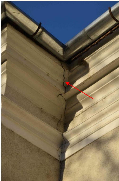
Foto nr. 23 – Fisură la partea superioară a pereților, în zona de intersecție (fațadă sud-vestică)
