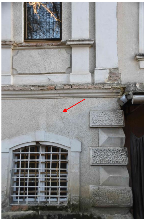
Foto nr. 18 – Fisură datorată cedării buiandrugului (fațadă sud-estică)
