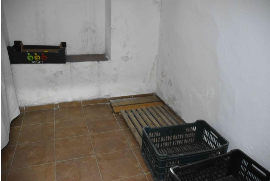
Foto nr. 37 – Degradări cauzate de infiltrații de apă, igrasie – spațiu de depozitare demisol
