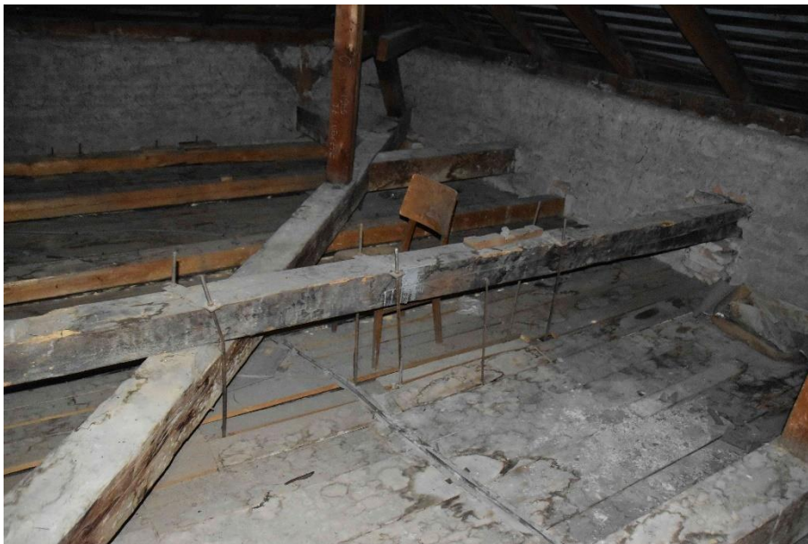
Foto nr. 51 – Consolidare locală planșeu de pod zonă colț nordic
