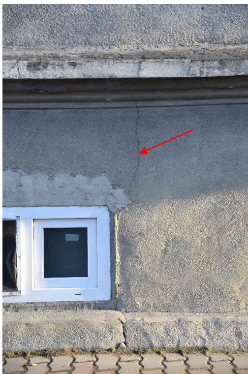
Foto nr. 19 – Fisură în zona golului de geam (fațadă nord-vestică)
