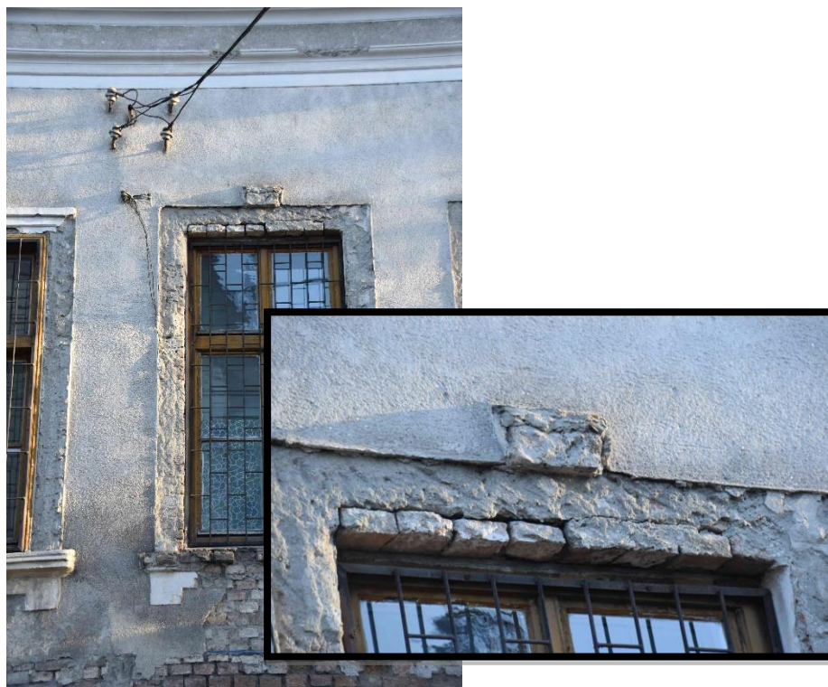
Foto nr. 21 – Degradări ale buiandrugului din zidărie de cărămidă plină (fațadă nord-vestică)
