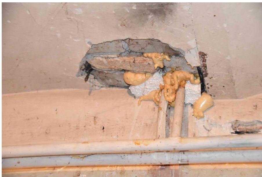
Foto nr. 31 – Gol de instalații realizat necorespunzător - magazie demisol zona interax 1-2/B-E
